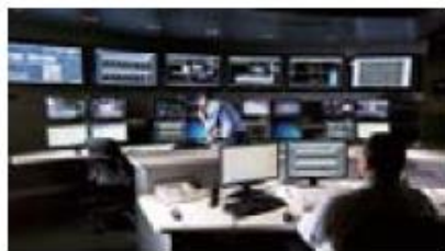
Центр управления и контроля
